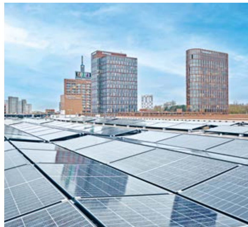
Auf vielen Geschäftsstellen der Volksbank BRAWO, aber auch wie hier auf dem BraWoPark Shopping Center, betreibt die Unternehmensgruppe Photovoltaikflächen.
