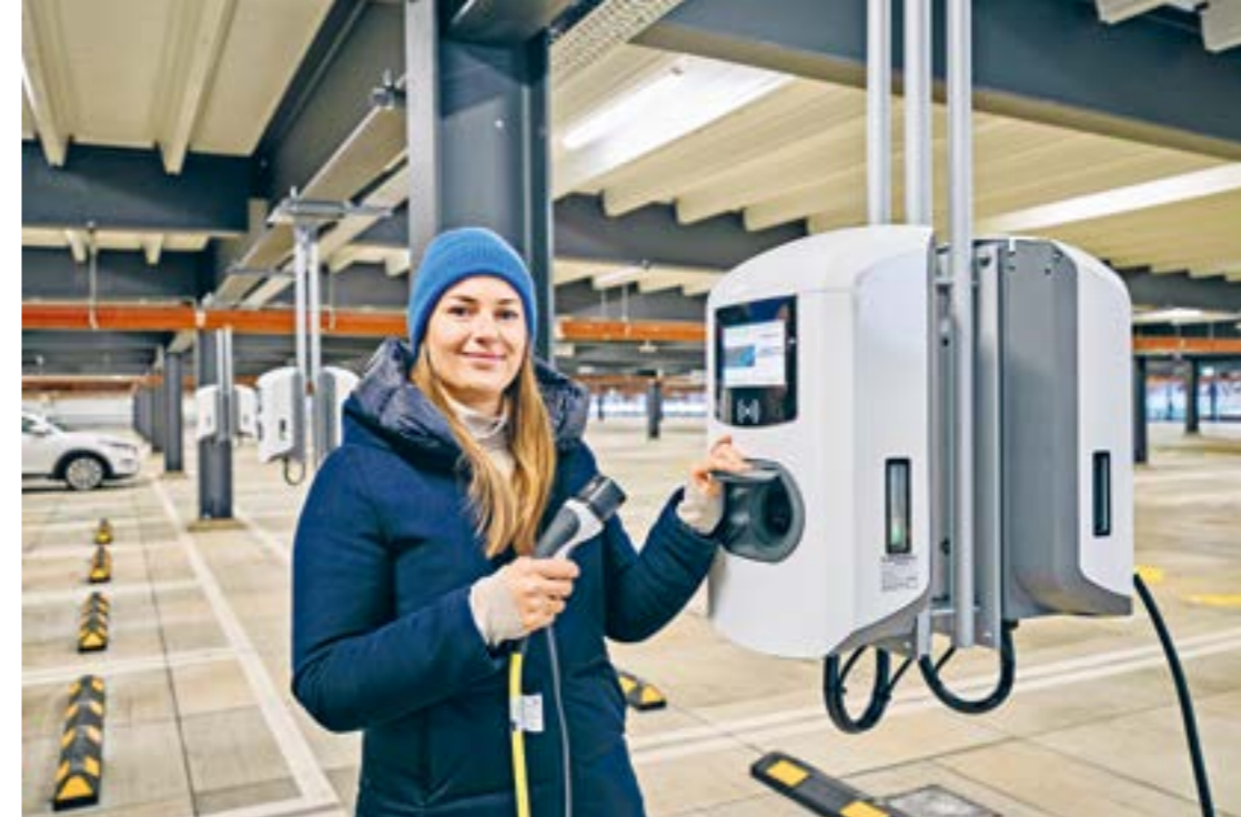
Insgesamt 70 Ladepunkte auf den Parkflächen des BraWoParks in Braunschweig hat die BRAWO Green Energy im Jahr 2024 in Betrieb genommen.
