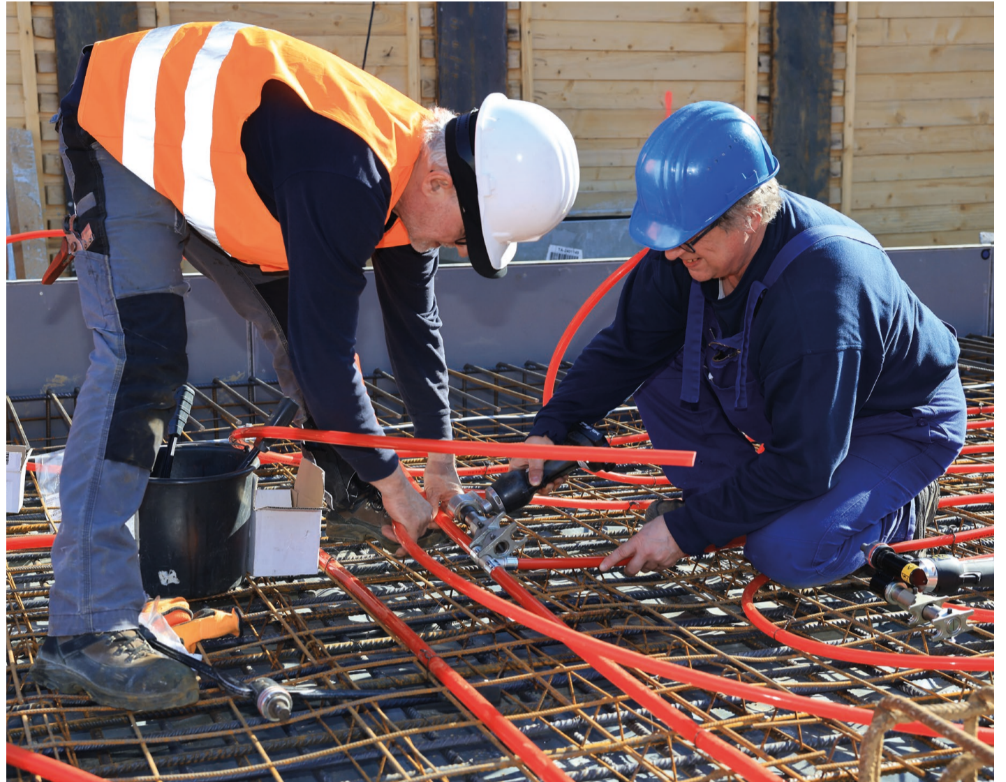
Die Betonkerntemperierung in den unteren Retail-Bereichen sorgt für ein gleichmäßiges Raumklima und geringeren Energiebedarf.
